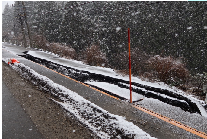
地点B（盛土崩壊）
